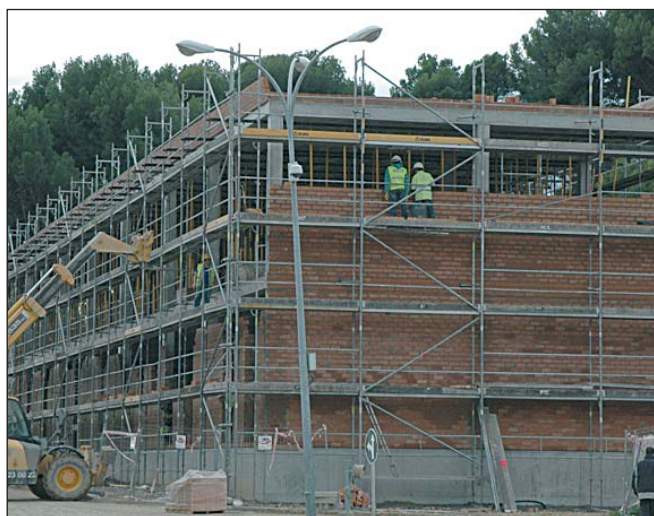
Arriba, el profesor Antonio Elipe en su despacho de la Academia. A la derecha, las obras del edificio que será la sede del CUD, que avanzan a buen ritmo.
